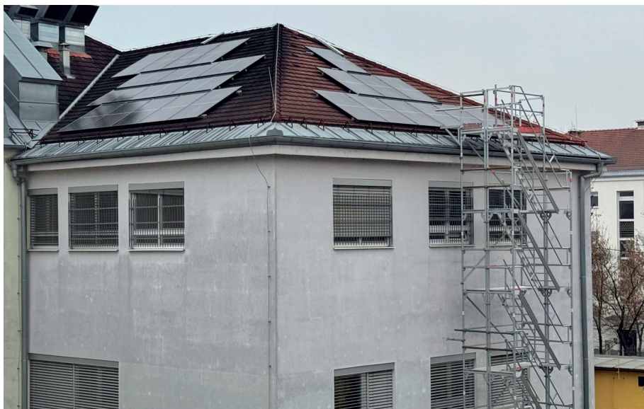
Sončna elektrarna na T-objektu
